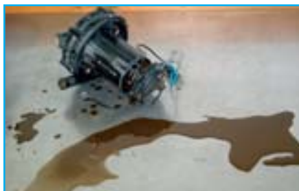
SI. 28 Kondenzat u pumpi dodatnog vazduha
