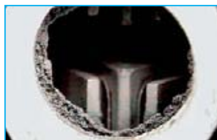
SI. 31 Naslage u nepovratnom ventilu
