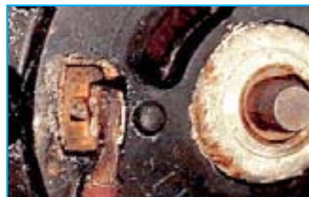
SI. 29 Pumpa dodatnog vazduha – korodirani električni priključci
