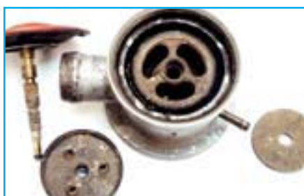
SI. 30 Ventil za dodatni vazduh – oštećenja membrane i tanjirića ventila zbog kondenzata
